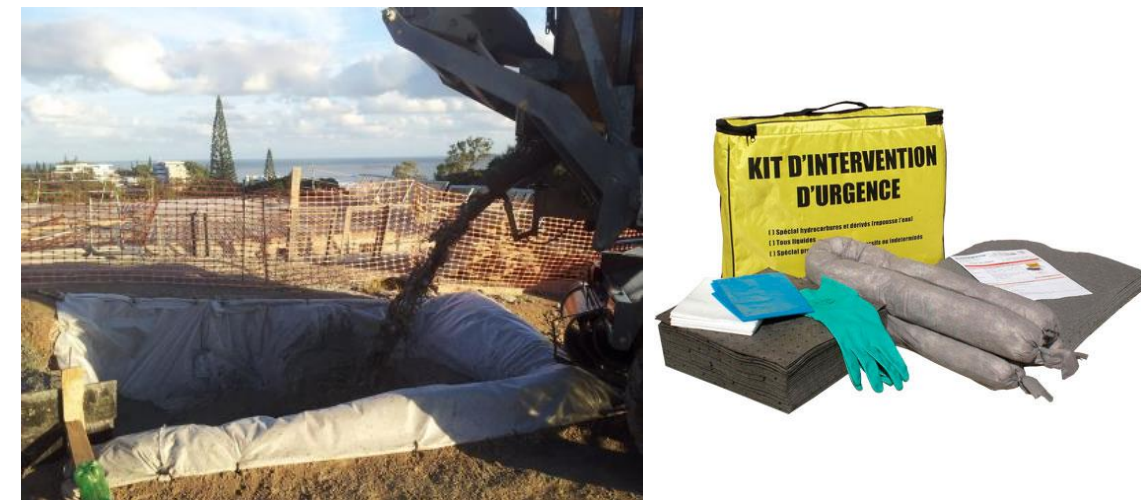
Figure 138 : Fosse de lavage du béton et kit anti-pollution (Source : Eurosorb)
