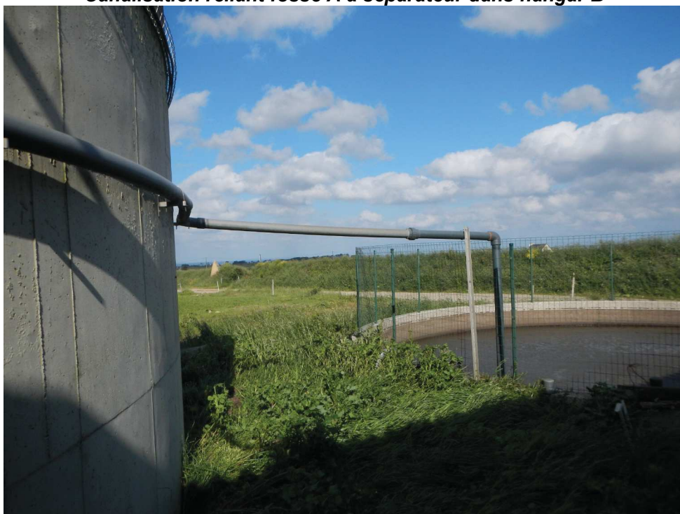
Canalisation reliant fosse A à séparateur dans hangar B
