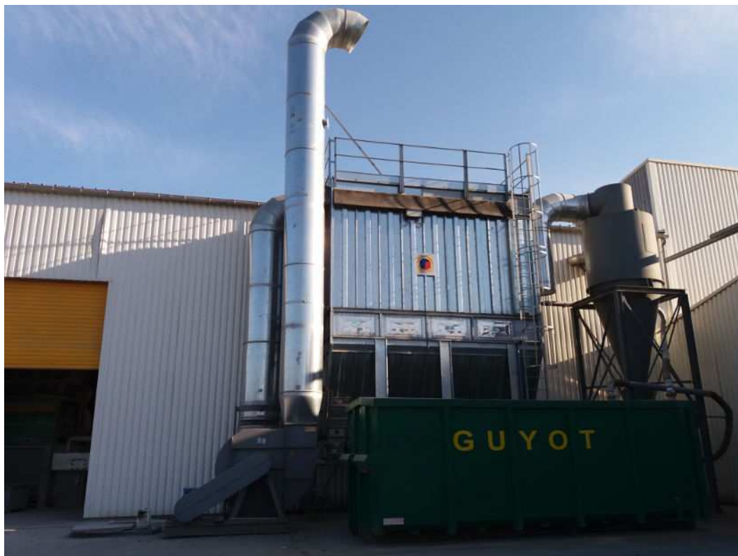
Figure 131 : Illustration du caisson de filtration et de la cheminée du rejet canalisé de l'air de la ligne DND
