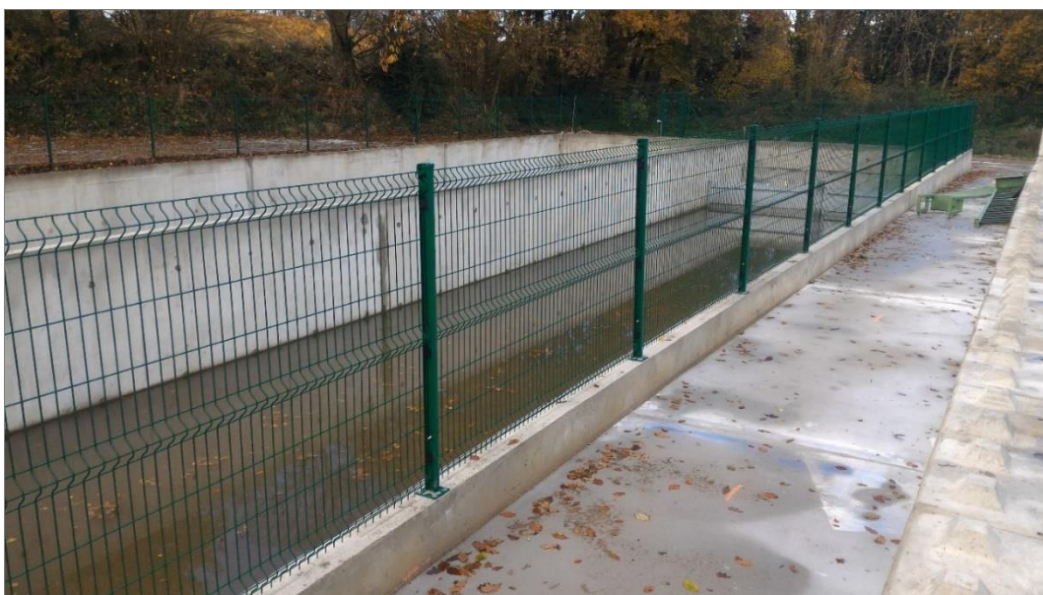
Figure 88 : Photo du double bassin de gestion des eaux pluviales
