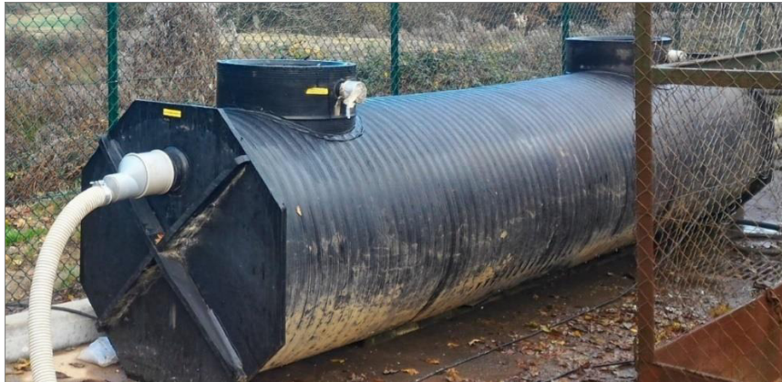
Figure 89 : Illustrations du séparateur d'hydrocarbures implanté en aval du système de gestion des eaux
