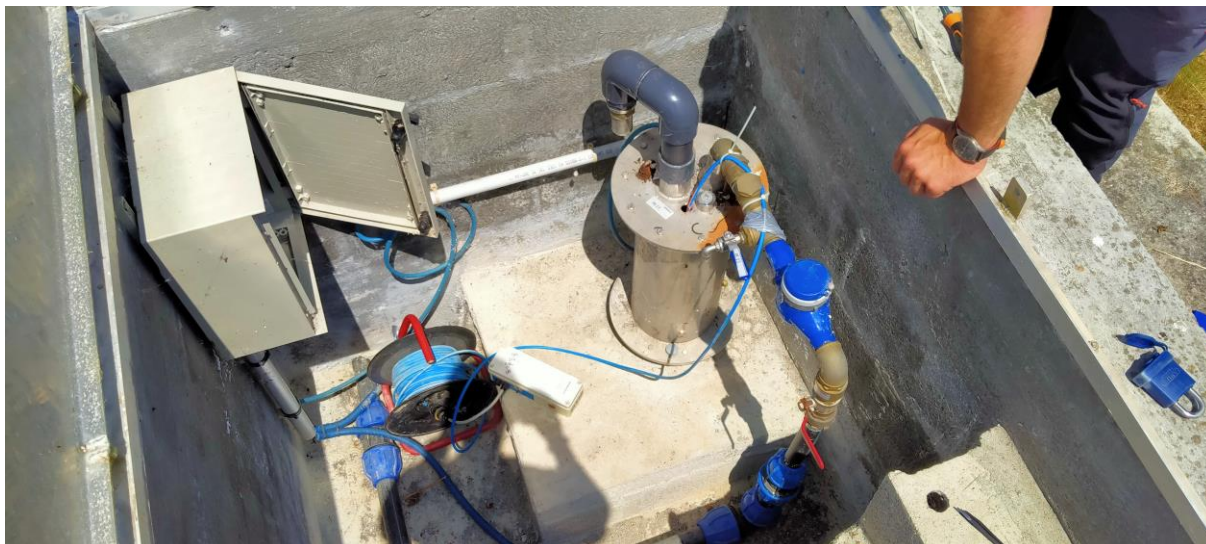
Figure 3 : matériel d'acquisition en place sur le forage F3 (Paratronic CNR + MAC10R)
