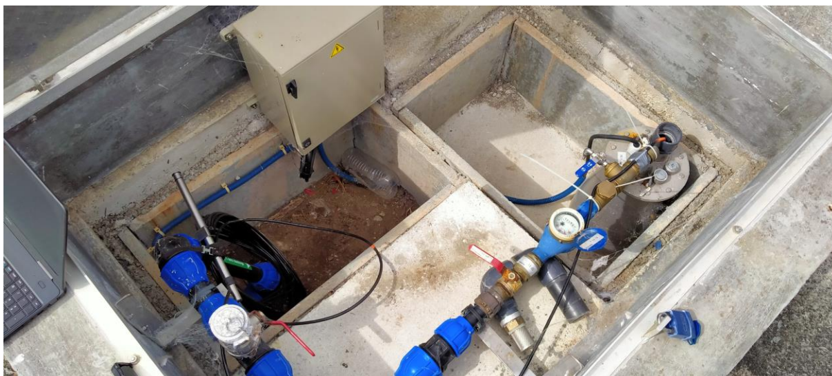
Figure 4 : matériel d'acquisition en place sur le forage F1 (OTT CTD)
