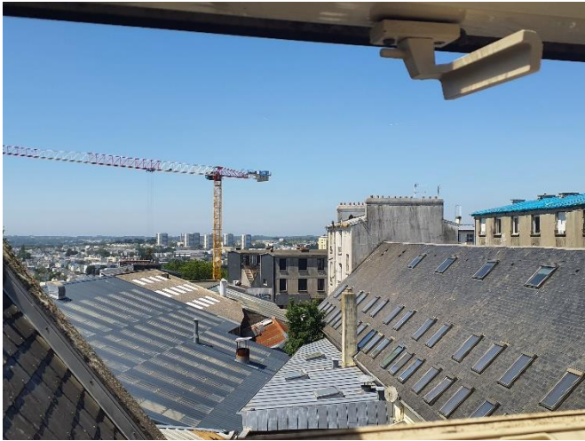
Figure 3. Toitures des bâtiments concernés par la démolition, le toit de l'ancien garage automobile à gauche abrite un nid de Goéland argenté (Biotope, 2023).
