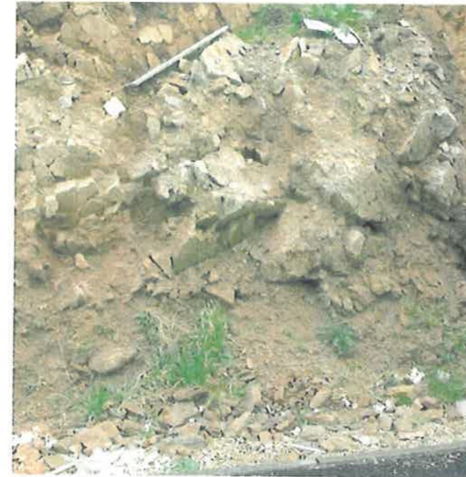
Exemples chutes de pierres dans un talus taillé dans des formations très fracturées et altérées
