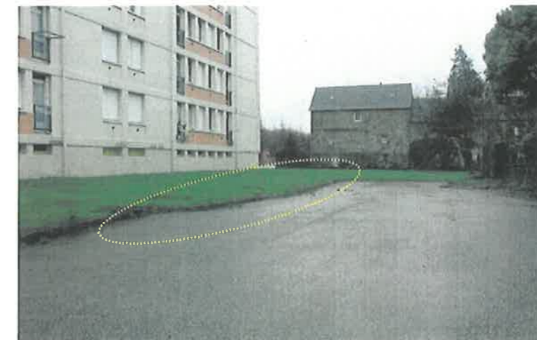
Exemple de désordres à Pouldavid : Déformation de la chaussée et des bordures
