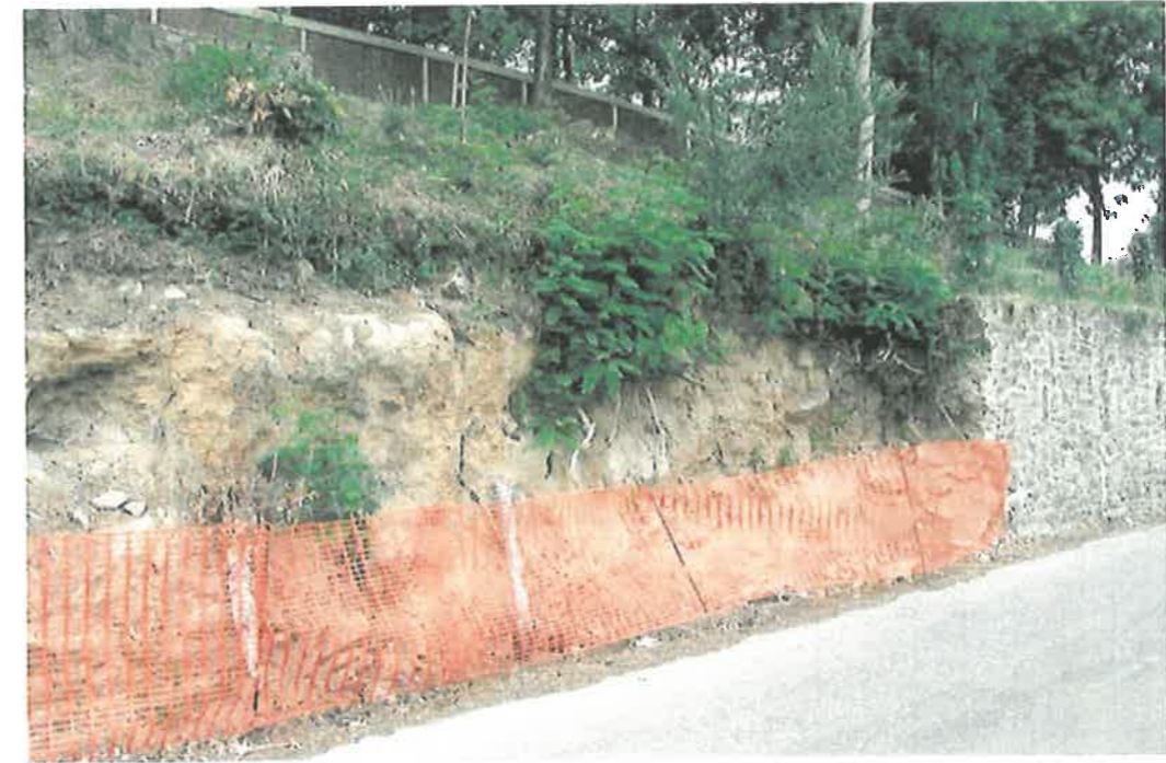
Exemples de désordres en milieu anthropique à Tréboul
