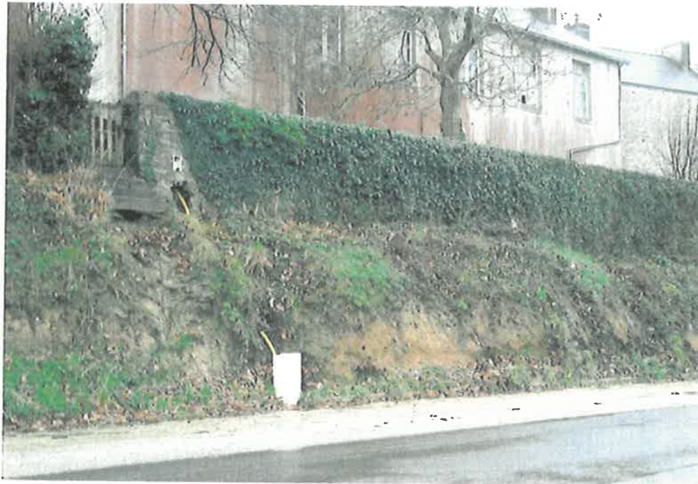
Illustration d'un aléa de glissement superficiel (G1) localisé route d'Audierne
