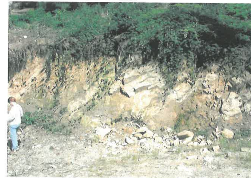
Exemples de chutes de blocs dans un talus de faible hauteur taillé dans des matériaux très fracturés
