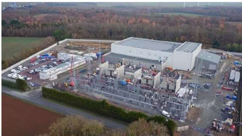
Figure 7 : Exemple de station de conversion existante – Chantier de Tourbe (à proximité de Caen)
