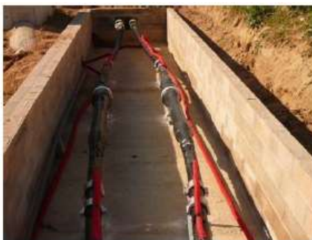
Figure 19 : exemple de chambre de jonction terrestre
