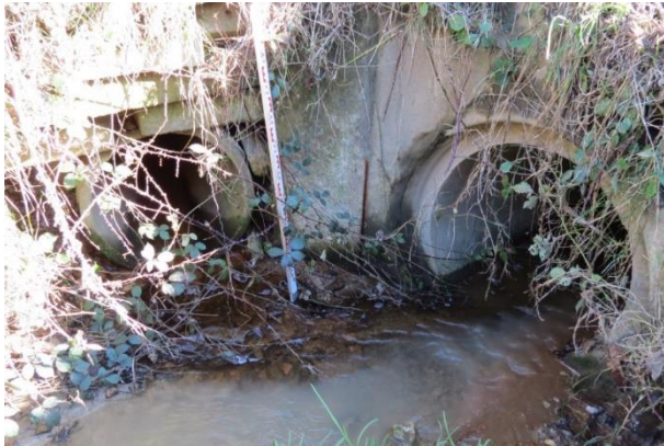
Figure 24 : Buse (à droite de l'image) sous voie d'exploitation existante (Ouest-Am)
