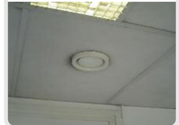
Photo 10 : Bouche de soufflage d'air dans une cantine
