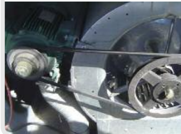
Photo 2 : Courroie ventilateur en bon état
