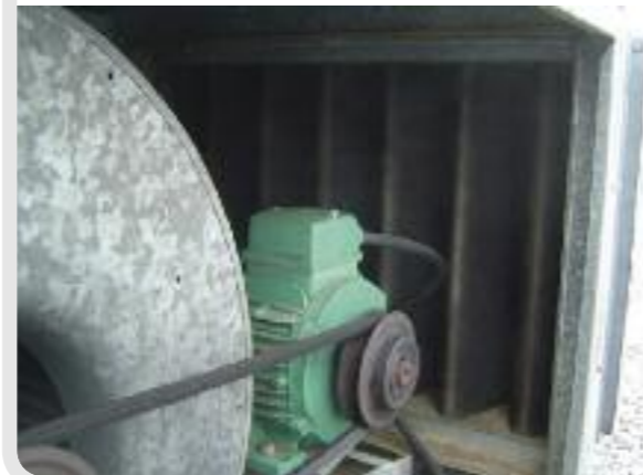
Photo 4 : Intérieur CTA avec filtre à air
