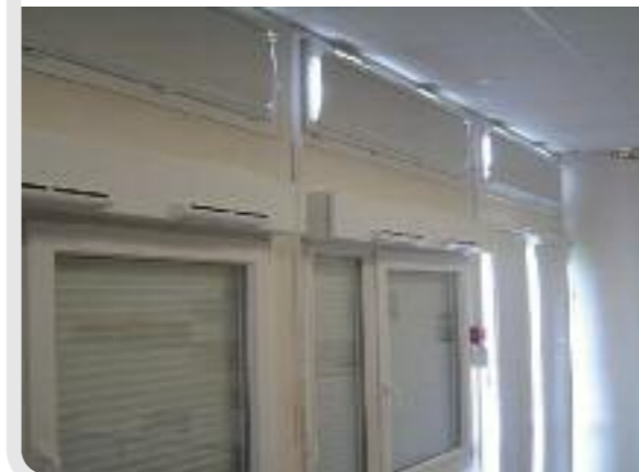
Photo 9 : Entrées d'air dans un dortoir
