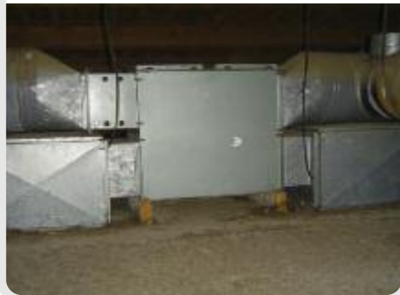
Photo 1 : Centrale double flux dans des combles
