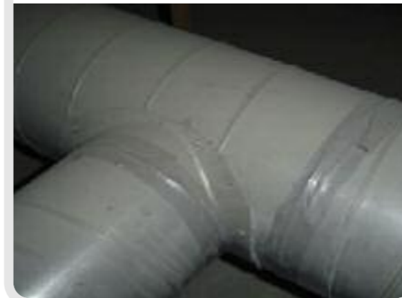
Photo 5 : Conduits étanches en combles
