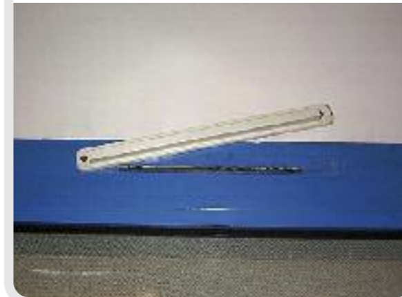
Photo 7 : Entrée d'air avec réservation trop étroite
