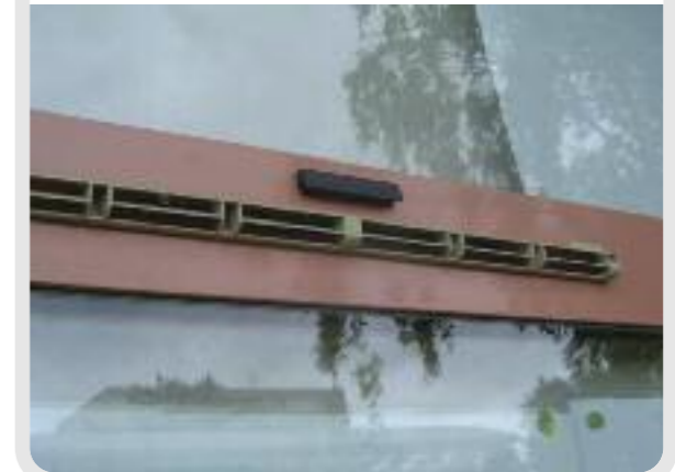
Photo 8 : Entrée d'air dans une fenêtre
