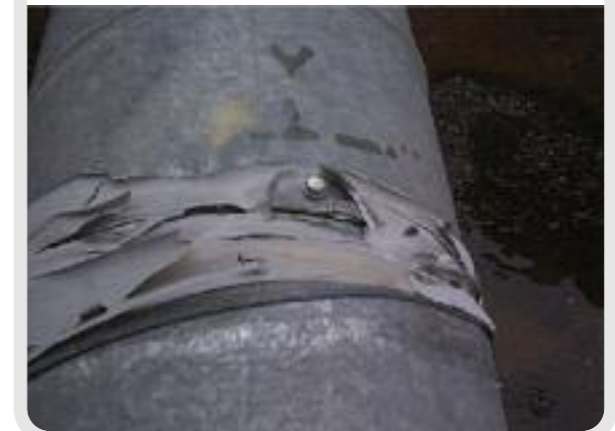
Photo 6 : Adhésifs détériorés sur conduits extérieurs
